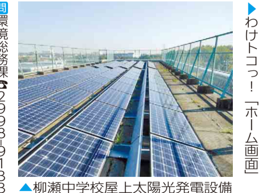
▲柳瀬中学校屋上太陽光発電設備
