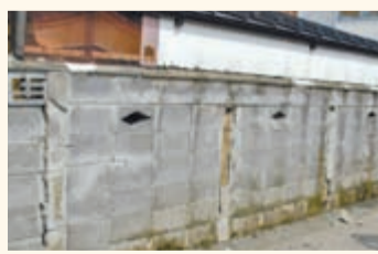
▲ブロック塀にヒビ割れがある
