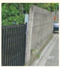
▲ブロック塀が傾いている
