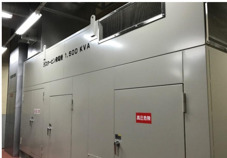
非常用発電設備
