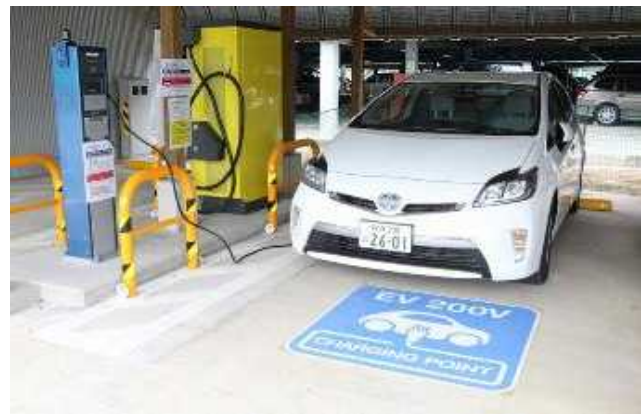
電気自動車等用充電設備 (市民体育館)
