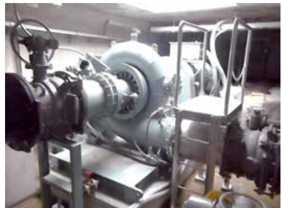
小水力発電設備
