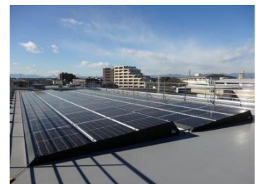
■太陽光パネル（上下水道局庁舎屋上）
