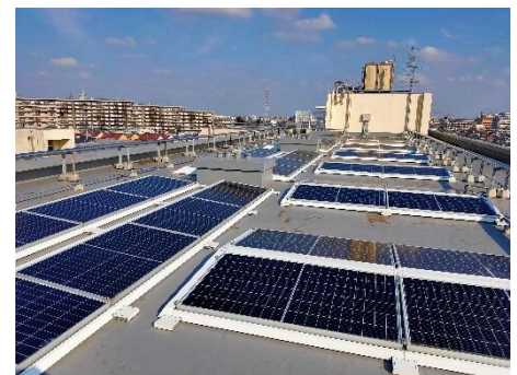
■太陽光パネル（向陽中学校屋上）
