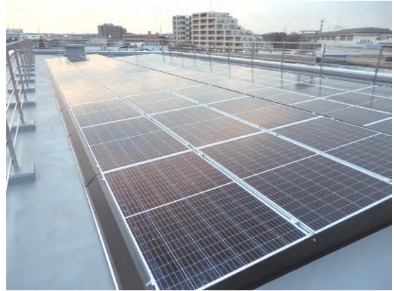
上下水道局庁舎屋上に設置の太陽光パネル
