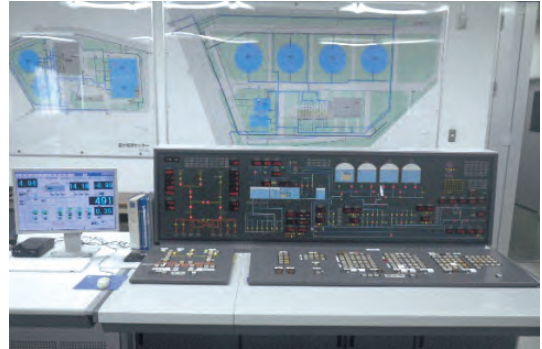
第一浄水場の監視室の様子
