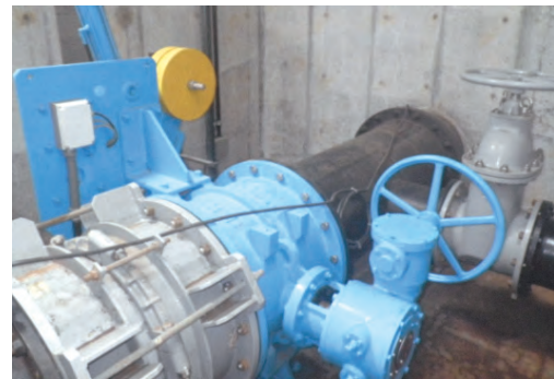
南部浄水場 緊急遮断弁
