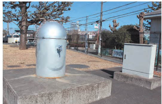
第一浄水場に設置された取水井
