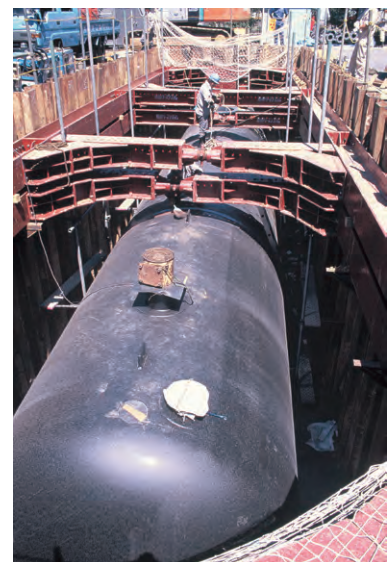
学校内に布設した耐震性貯水槽
