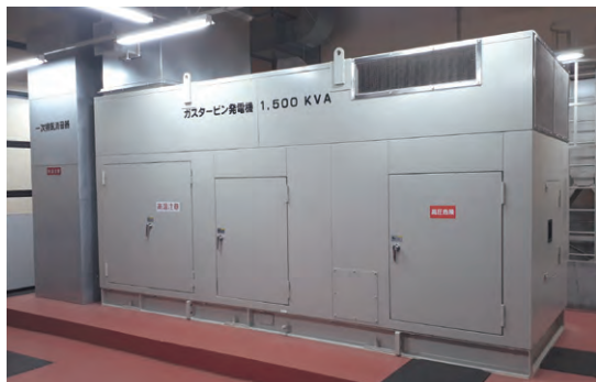
東部浄水場 自家発電設備
