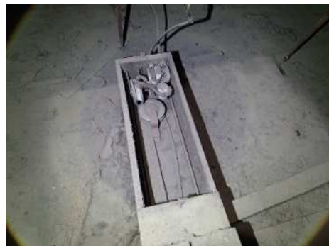
電灯昇降機内部
