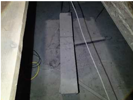
離れの天井で見つかった電灯昇降機
